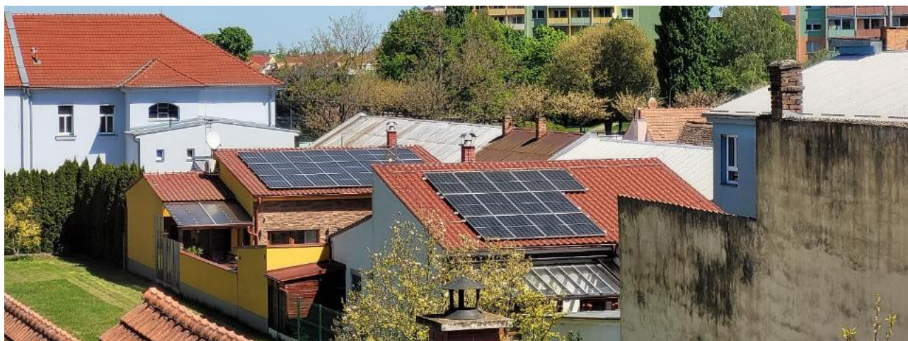
Obr. 49: Fotovoltaika na privátní objektech
