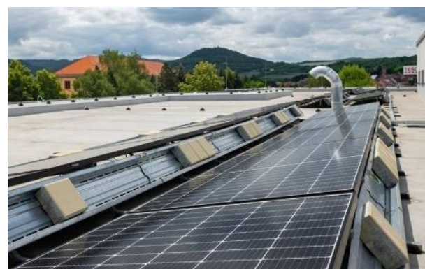
Střešní fotovoltaická elektrárna (Kulturní centrum Klášterec nad Ohří).
