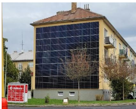
Fotovoltaická elektrárna na jižní straně budovy snižuje emise skleníkových plynů a přináší provozní úspory (Valašské Klobouky)
